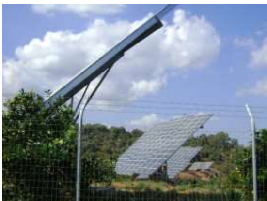
FIGURA 20. PANOURI FOTOVOLTAICE MONTATE PE SOL ÎN CRETA (Sursa: ReSEL, TUC)
