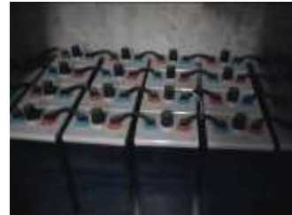
FIGURA 155. INSPECȚIA BATERIILOR LA SISTEMELE AUTONOME, CIPRU. (Sursa: Cyprus Energy Agency)
