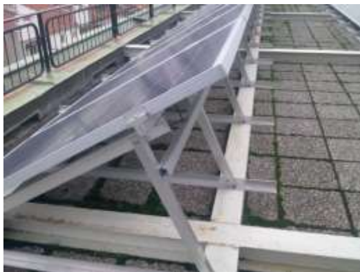
FIGURA 149. CABLURI ȘI CONDUCE AMPLASATE ÎN SPATELE MODULELOR PV
