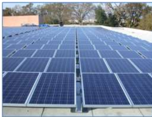
FIGURA 19. PANOURI MONTATE PE UN ACOPERIȘ PLAT (Sursa: Flickr, Entersolar, 2011)
