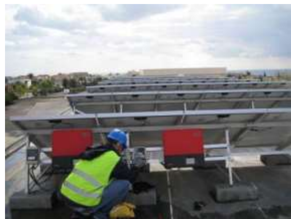
FIGURE 1. MĂSURAREA LA UN SISTEM PV AMPLASAT PE ACOPERIȘ, CONECTAT LA REȚEA (Sursa: Conercon Ltd)
